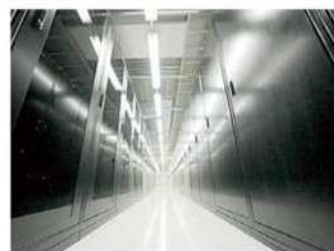
データが保管されるサーバールーム
